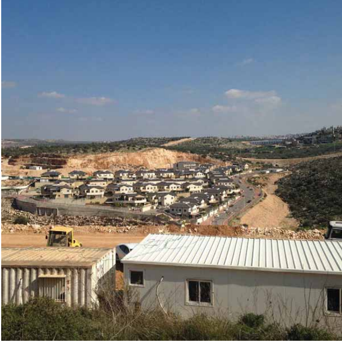
جرافة تسوي الأرض تمهيدا لبناء مشروع أهدوت إلكانا في مستوطنة إلكانا الإسرائيلية. © 2017 هيومن رايتس ووتش
