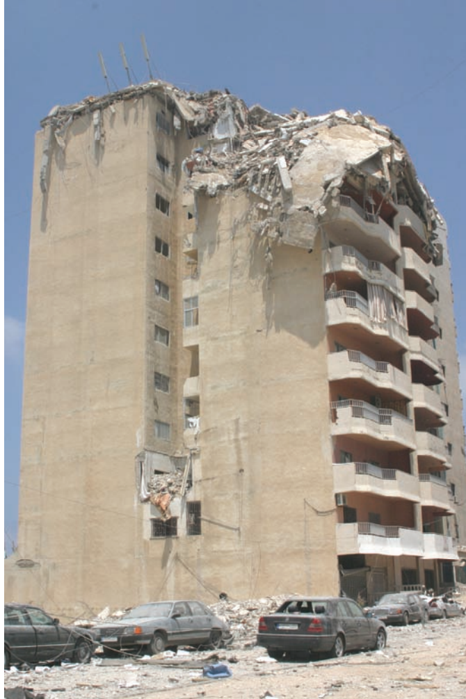
בניין מטה ההגנה האזרחית בעיר צור לאחר התקפה אווירית של ישראל ב-16 ביולי 2006, שבה נהרגו 14 אזרחים ונפצעו אזרחים רבים נוספים. המודיעין הישראלי זיהה בטעות את הבניין בתור "מטה חיזבאללה" בצור.
